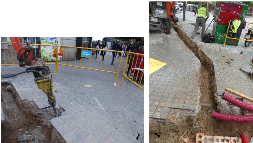
A l'esquerra imatge inicial de la rasa. A la dreta, procés d'excavació.
